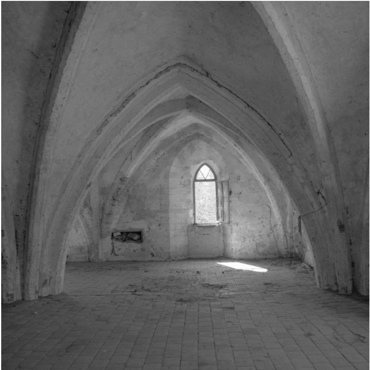
Bas-côté sud, vue intérieure : baie décalée dans son ébrasement et trace d'une ancienne porte (?).
