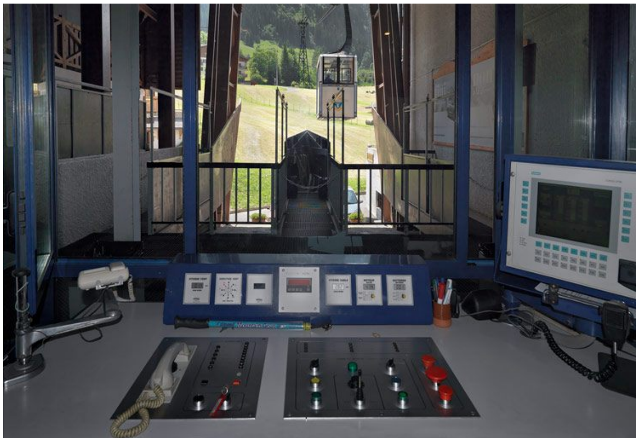
Gare inférieure. La console de commande
