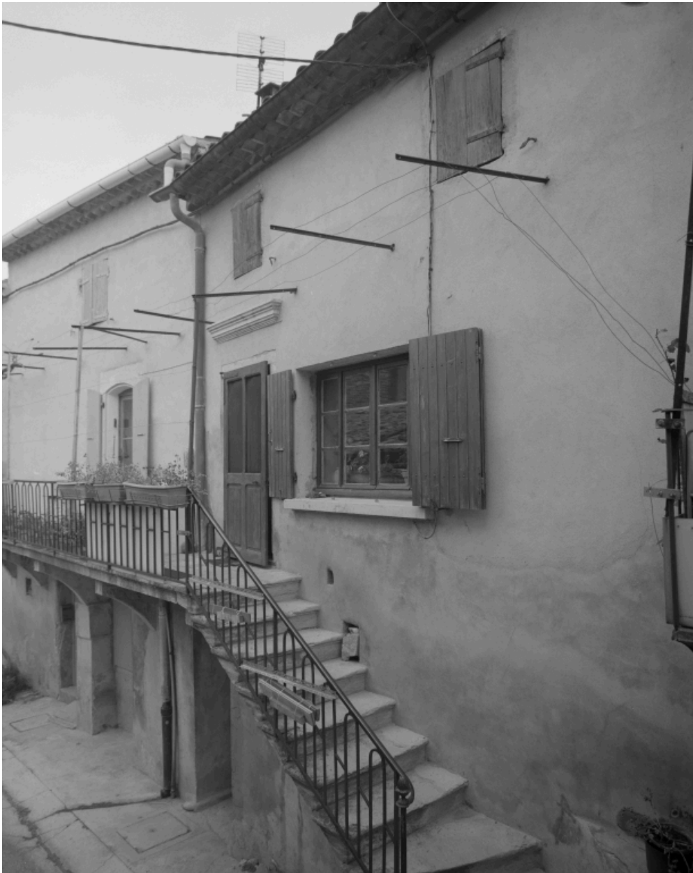
Le Pègue, Grand'rue. Maison (B3 648), vue partielle de l'élévation sur la Grand'rue.
