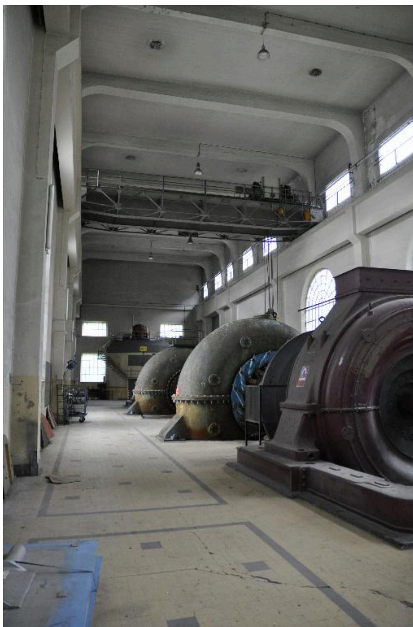
Vue intérieure de la salle des machines
