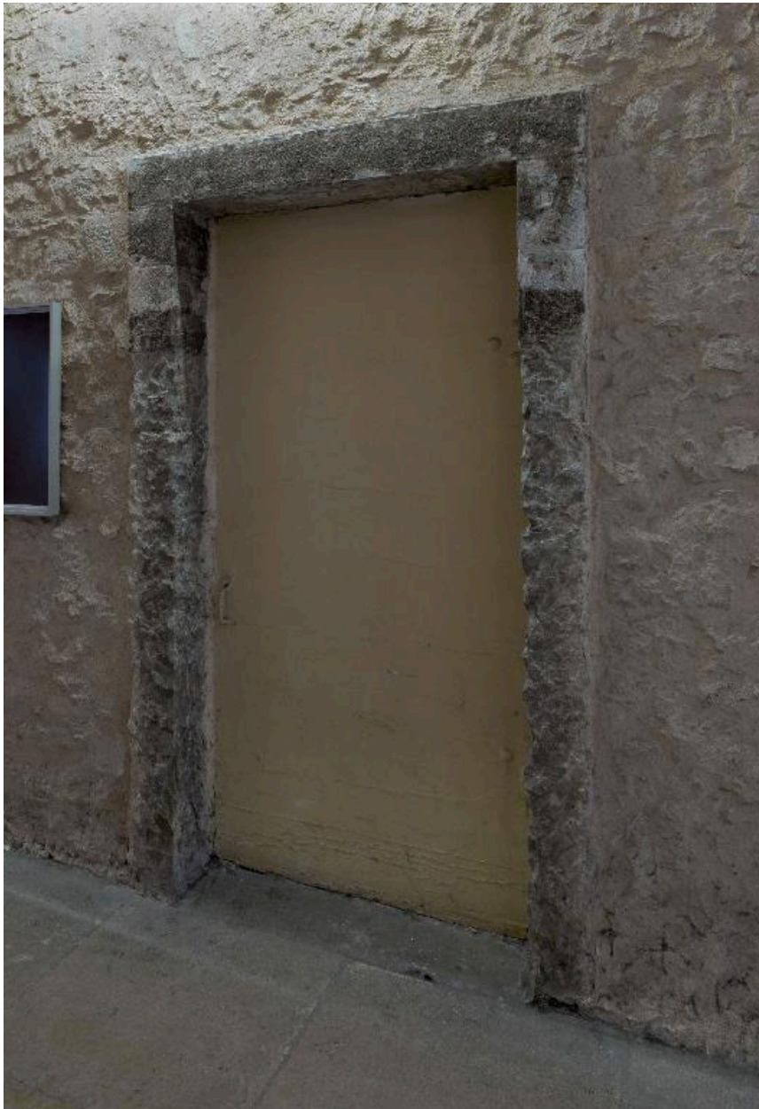
Couloir menant à l'escalier D : ancien passage vers la sacristie de la chapelle, aujourd'hui muré
