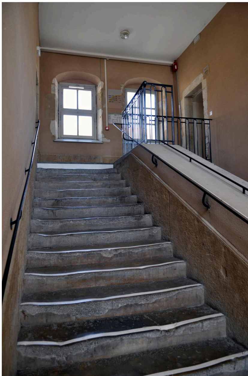
Bâtiment E : escalier de l'aile est de la cour des pères (actuel escalier D) : dernière volée
