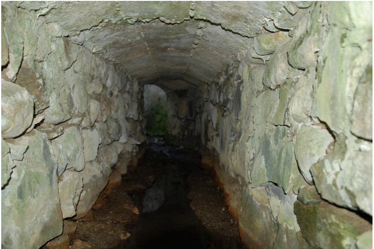
Conduit d'échappée de l'eau du moulin aval, vue intérieure d'aval en amont.
