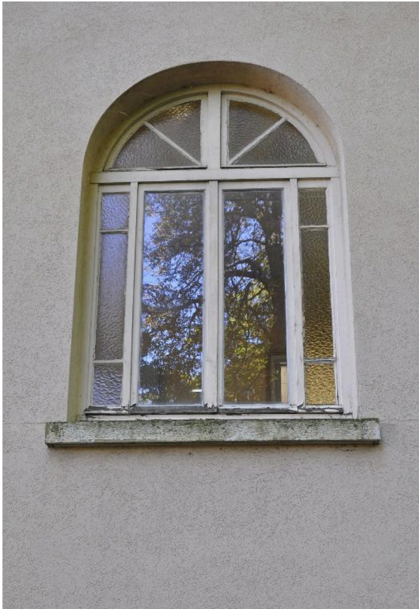
Bâtiment nord, élévation ouest : vue extérieure d'une fenêtre en plein cintre avec menuiserie en bois
