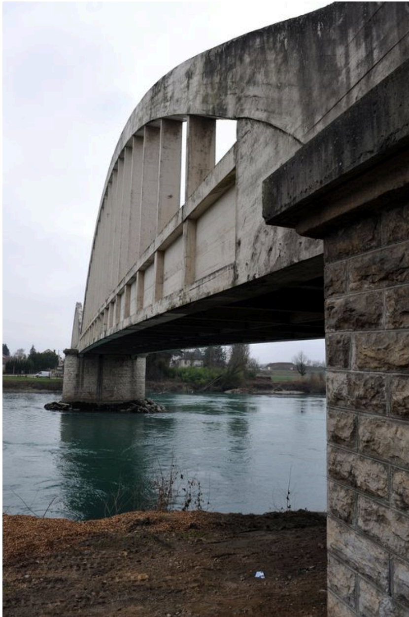
Vue partielle, de côté, travée droite, face amont (depuis la rive droite)
