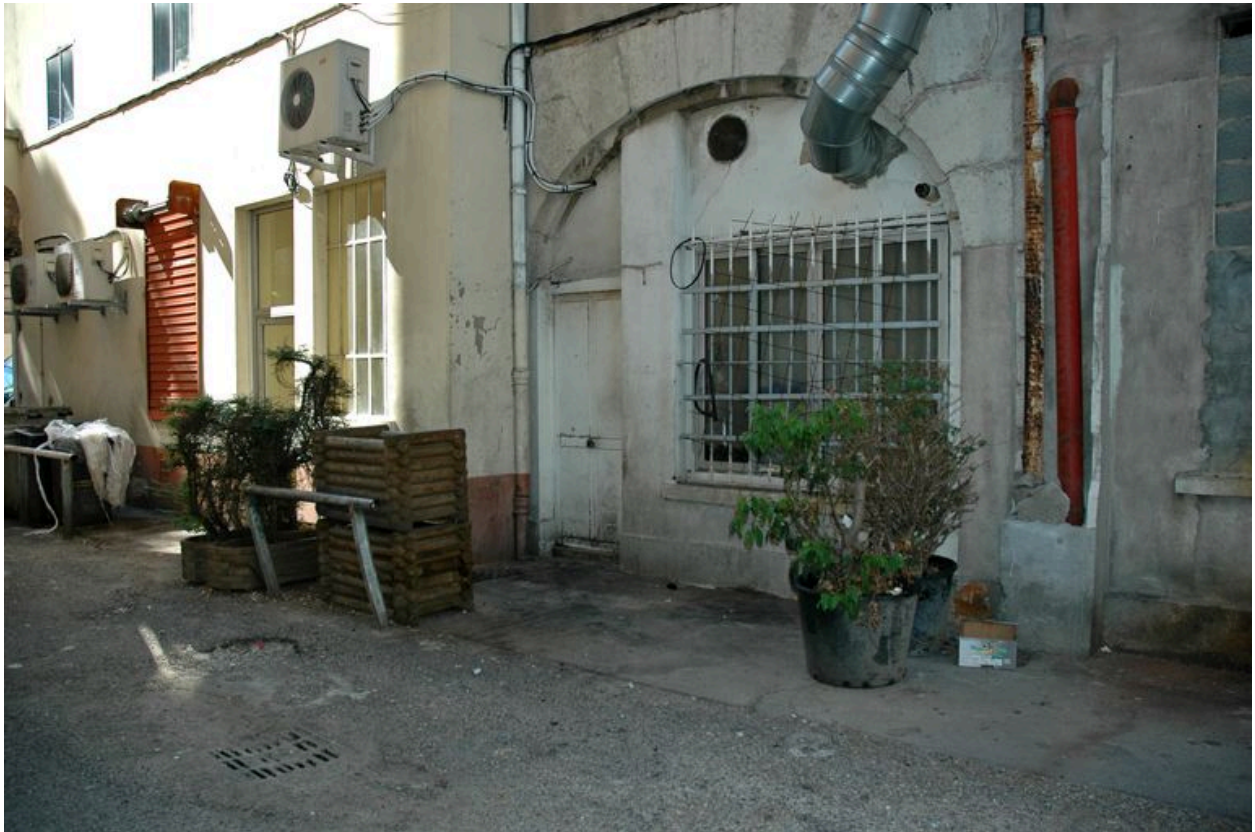
Entrée du 284 rue de Créqui et élévation postérieure du 107 grande rue de la Guillotière : vestiges d'une arcade du rez-de-chaussée
