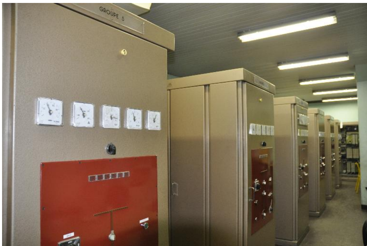
Vue de la salle de contrôle des groupes suivis
