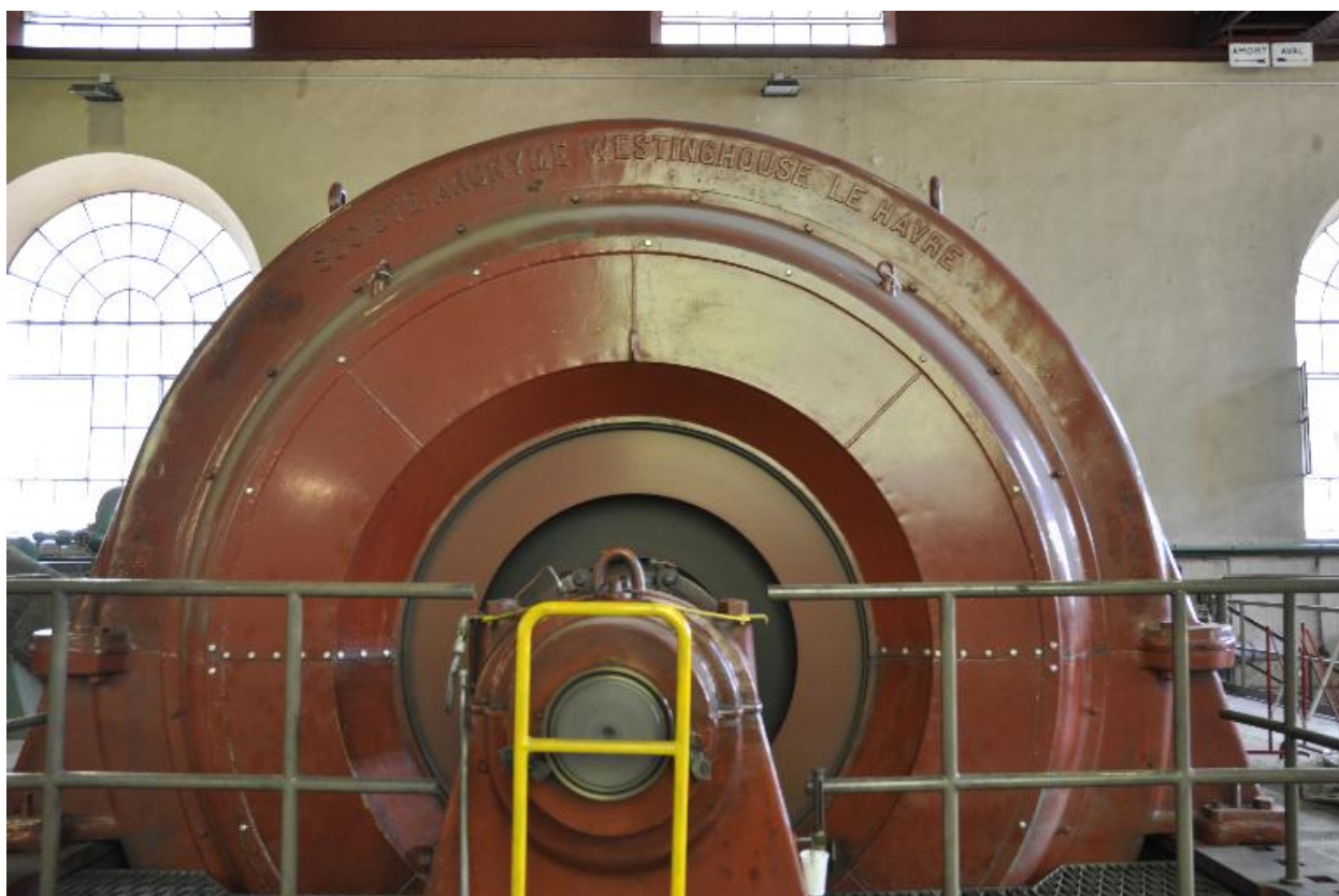
Détail salle des machines
