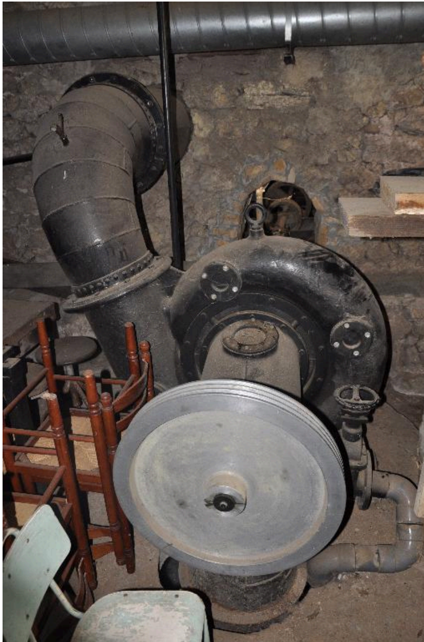
Vue de la turbine Francis, 2010.
