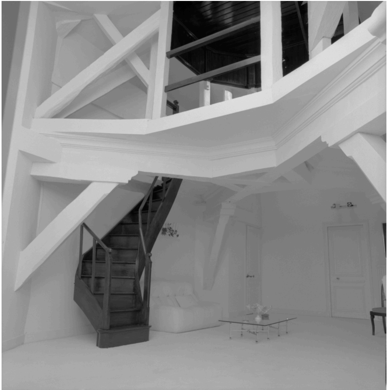
Etage de comble : vue de l'espace central de l'étage et de l'enrayure portant le belvédère, du nord-est.
