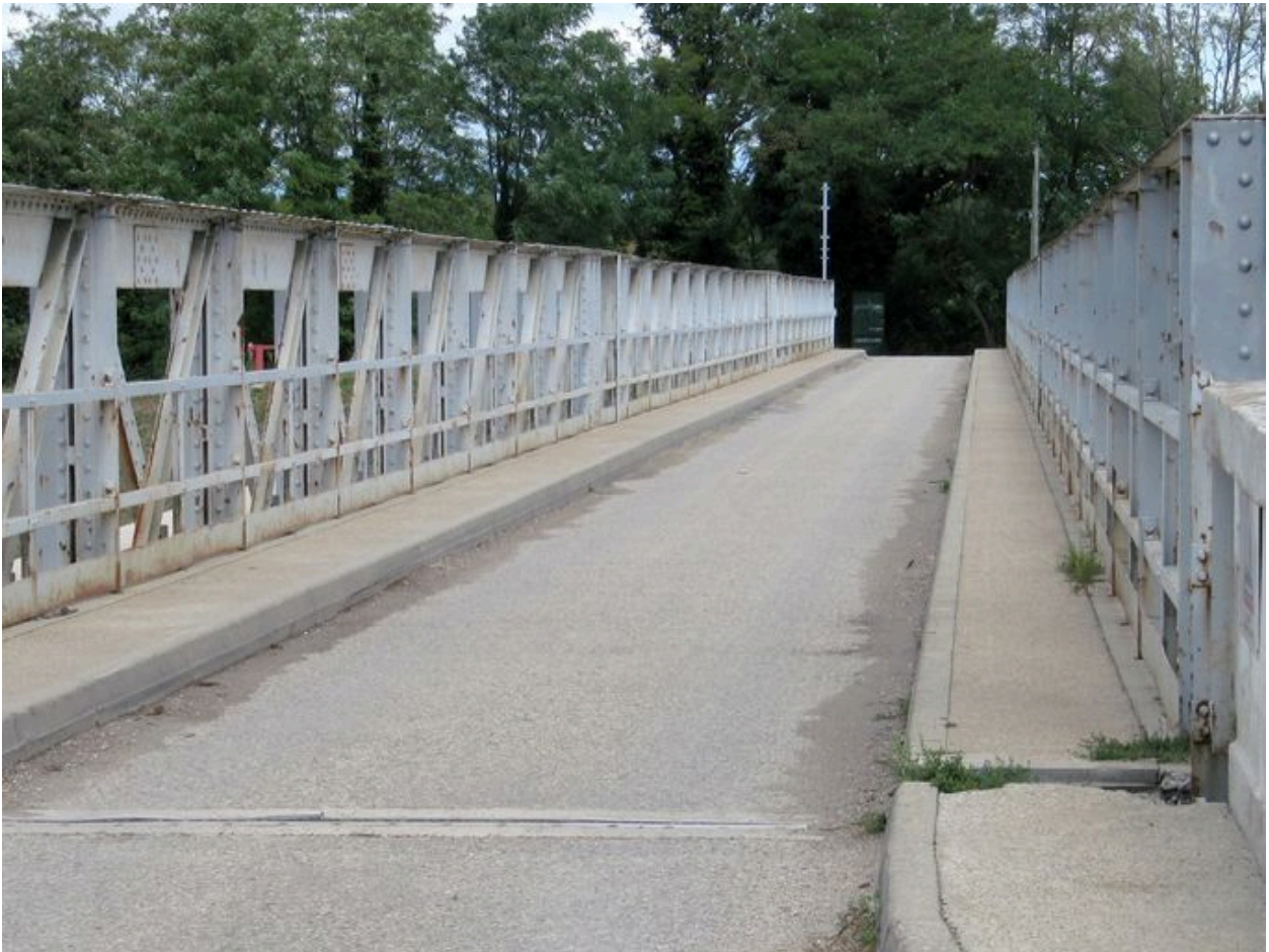
Vue partielle, de dessus, chaussée et structure métallique (depuis la rive gauche)
