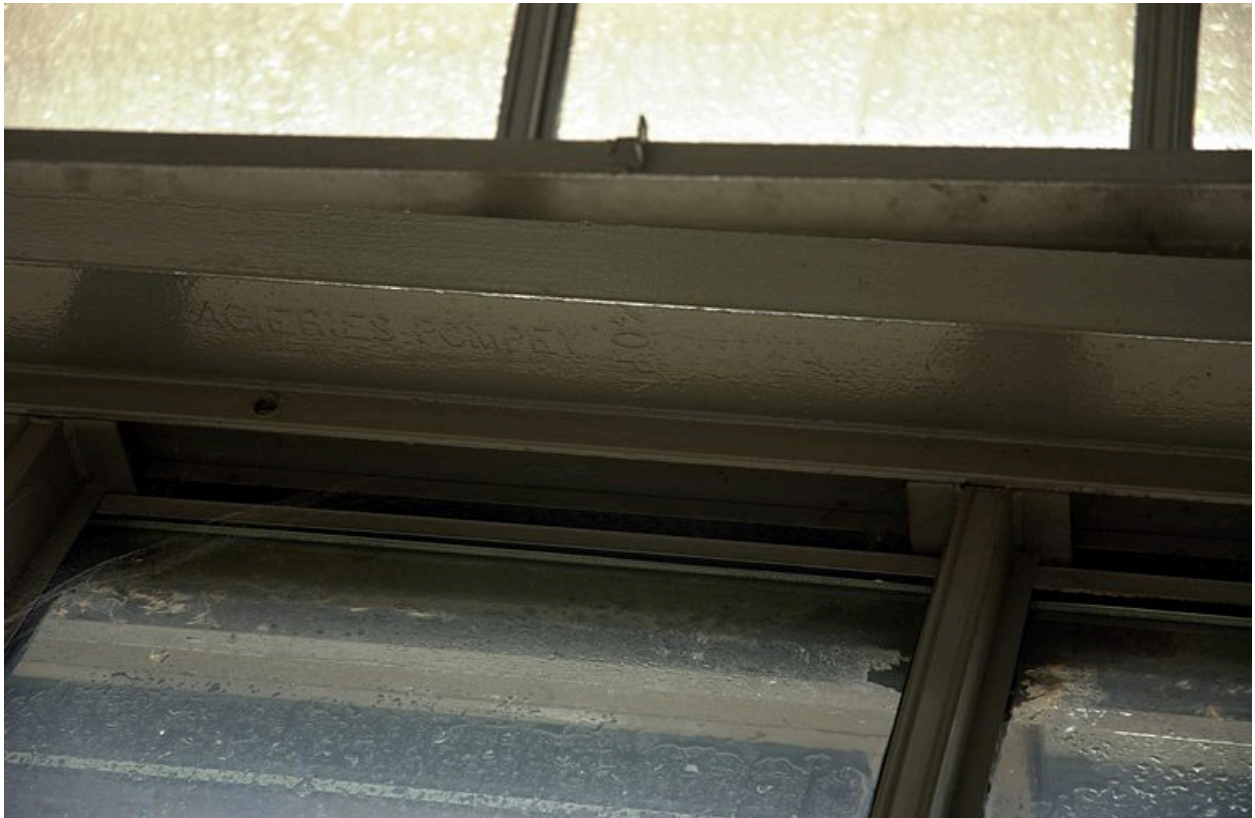
Verrière sur la cour principale, détail de la deuxième inscription : Aciéries Pompey
