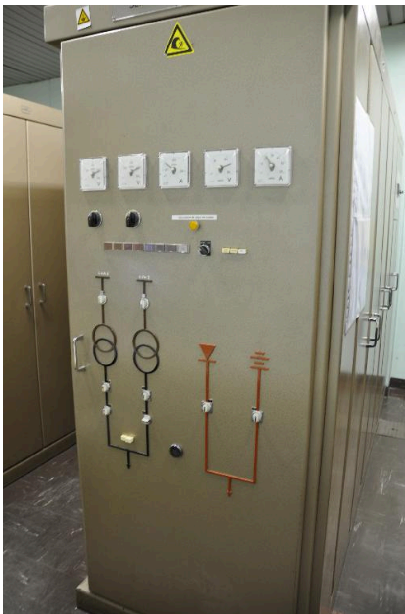
Vue d'un groupe de la salle de contrôle des groupes
