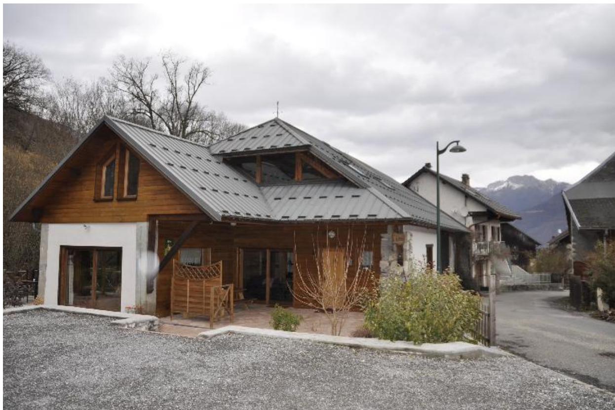
Mur pignon ouest du bâtiment de la remise
