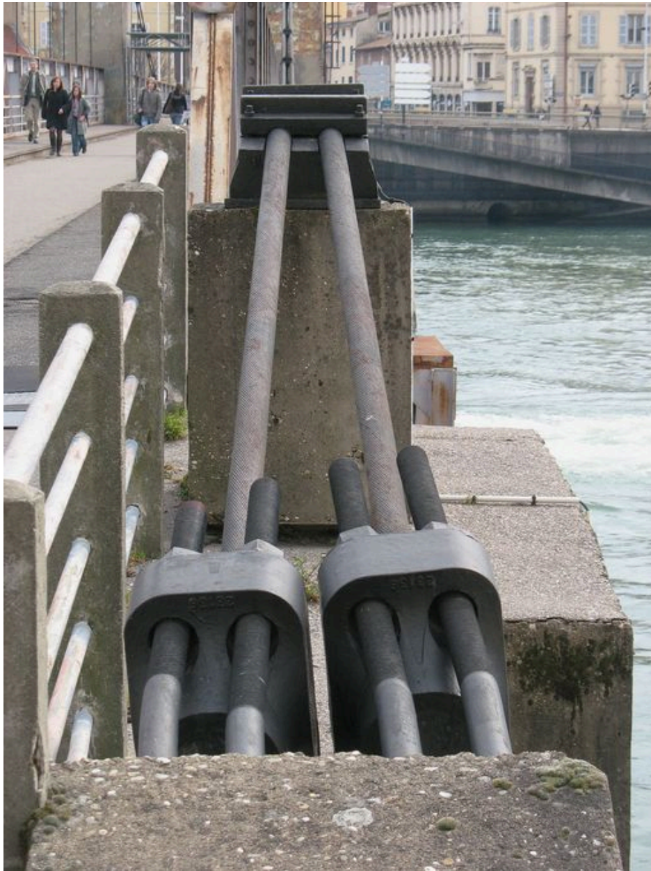
Culée droite, face aval, vue partielle : câbles d'ancrage (depuis la rive droite)
