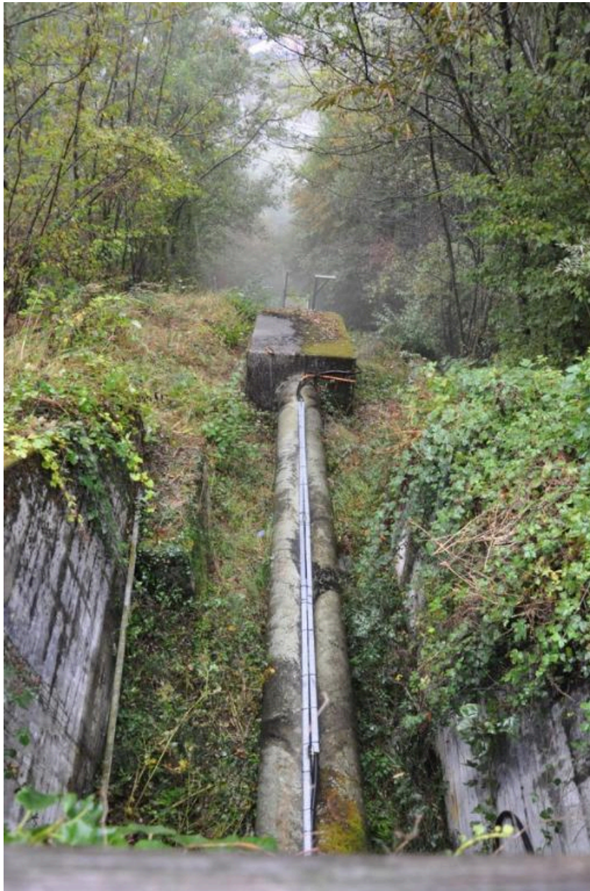
Conduite forcée vue depuis la route menant au hameau de la Planche (vue aval)
