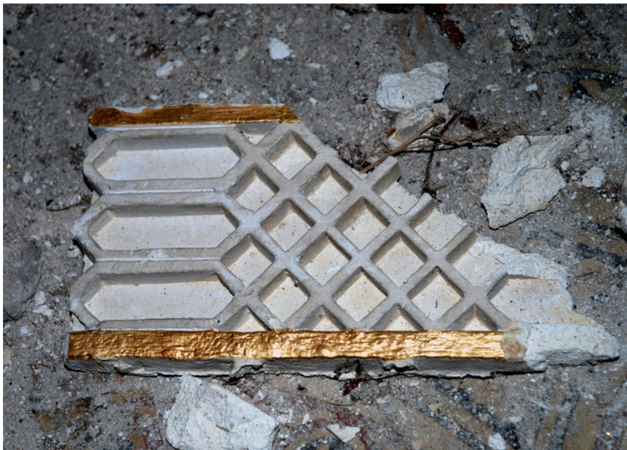
Plaque de stuc détachée de la coupole
