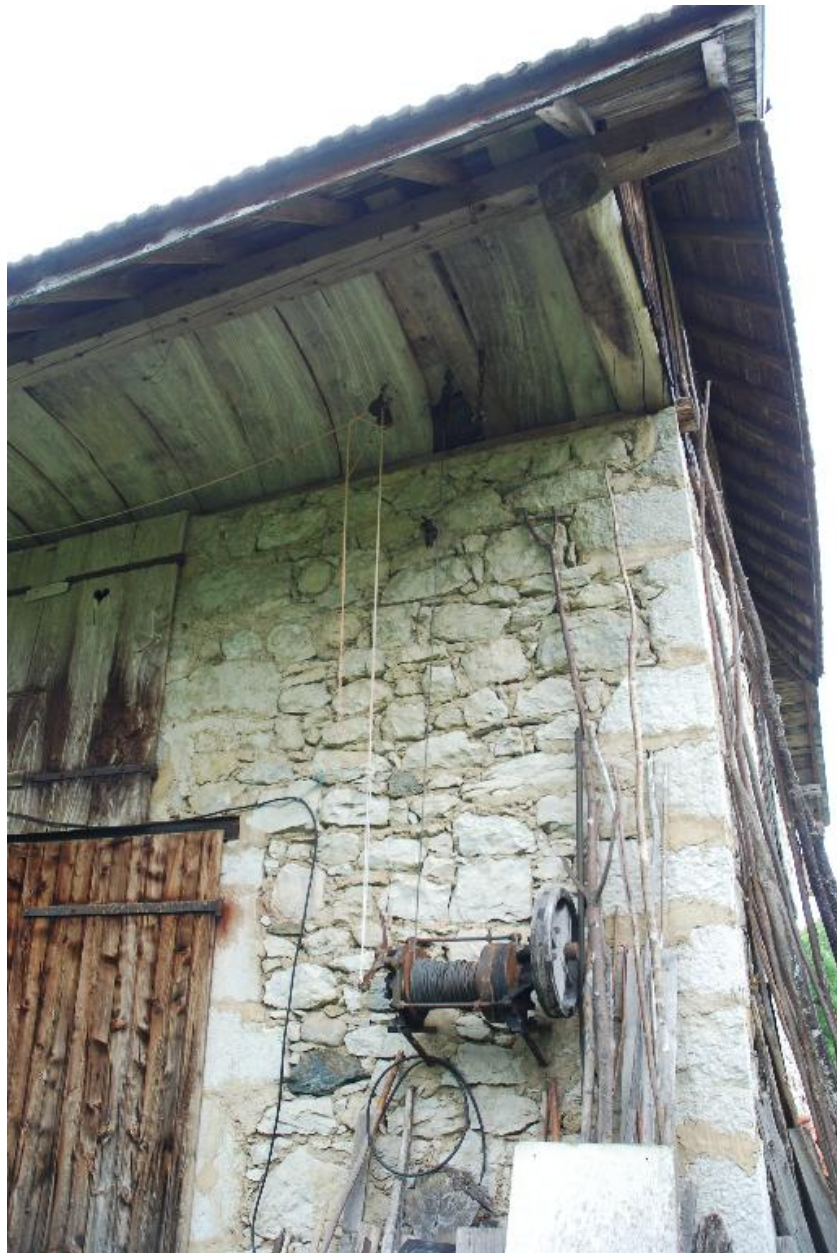
Détail du mécanisme d'élévation de charges.
