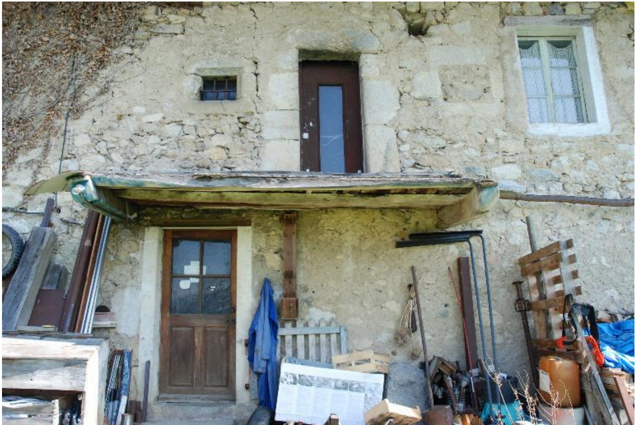
Détail des ouvertures du logis.
