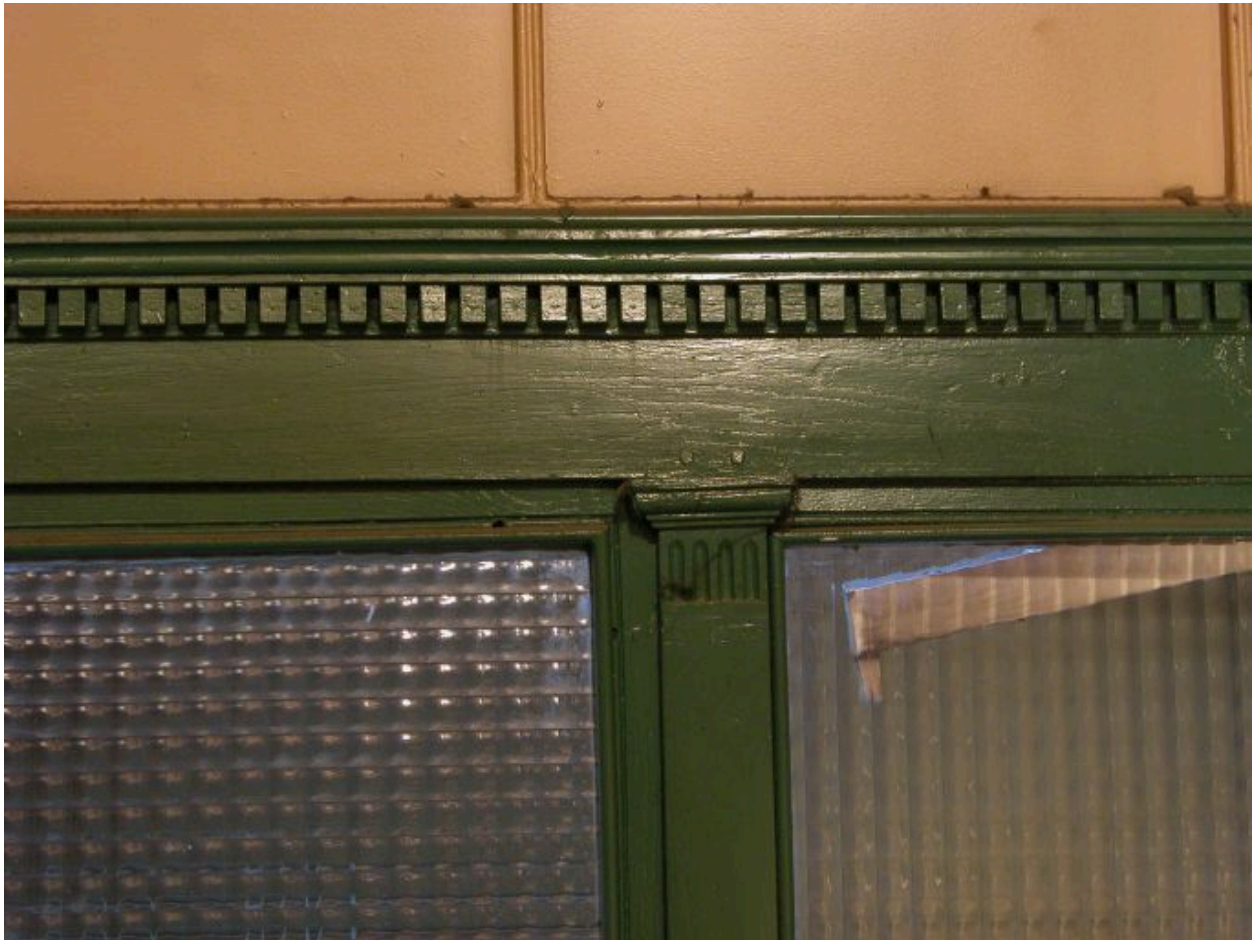
Rez-de-chaussée de l'escalier, repos, détail de l'entrée de l'ancienne loge de concierge
