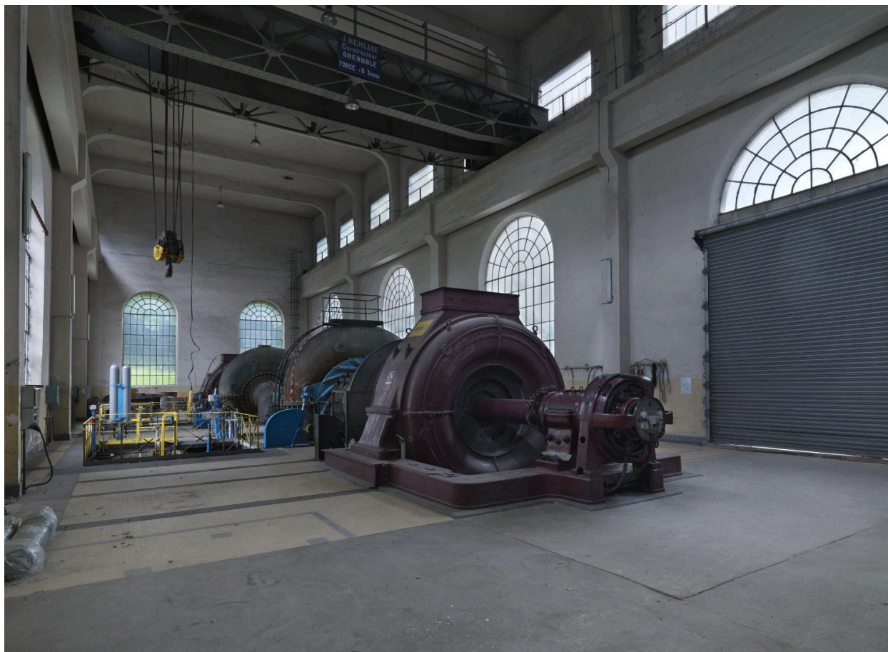
Salle des machines et groupes horizontaux
