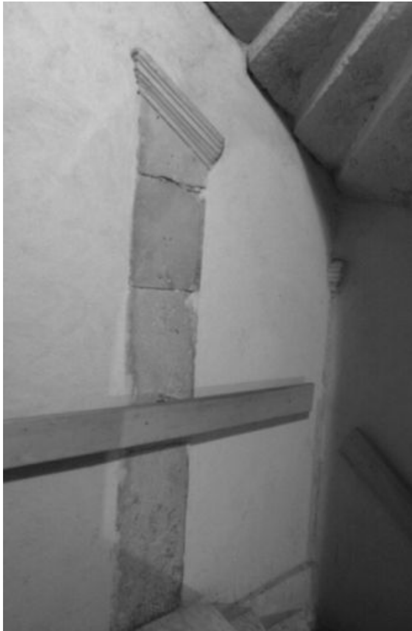
Escalier, traces des anciennes ouvertures sur la cour vues depuis le palier du premier étage
