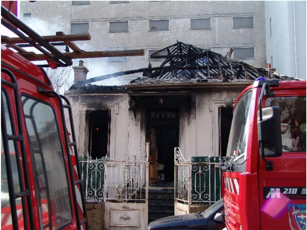
Détail sur la porte d'entrée de la maison incendiée
