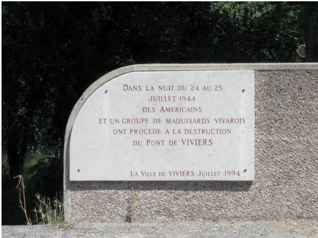
Parapet de la culée, vue partielle : plaque commémorative (depuis la rive droite)
