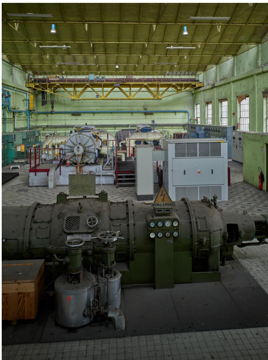
Salle des anciennes turbines de la chaufferie, dans le bâtiment B41.
