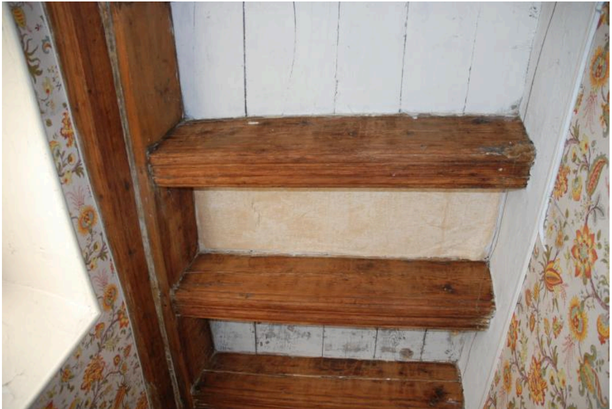
Corps principal, premier étage, partie sud, couloir (Cf. Plan étage 13), détail poutres du plafond.
