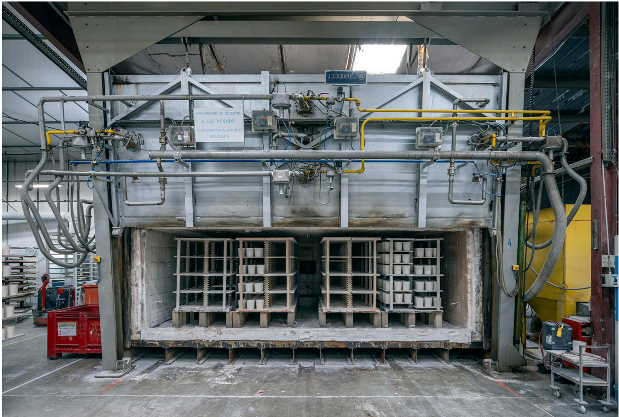
Four électrique : usine de céramique culinaire "Revol porcelaine"
