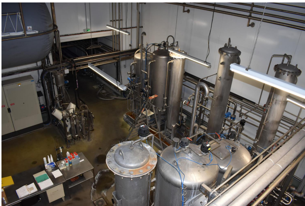
laboratoire de déferrisation
