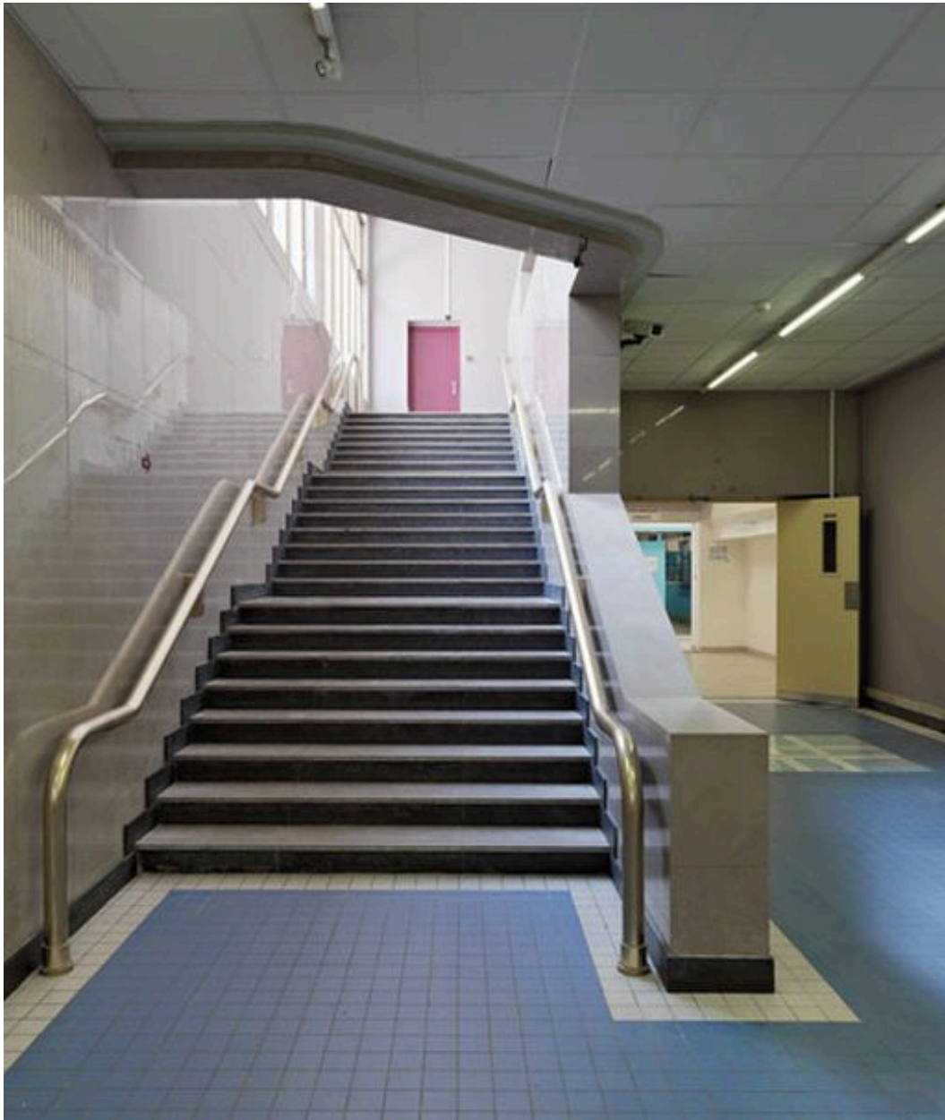
Vue de l'escalier menant à l'ancien comptoir d'accueil et aux vestiaires (état en juin 2012).
