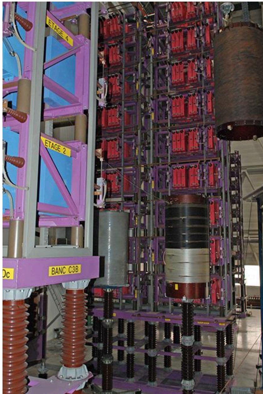
Vue du matériel de test
