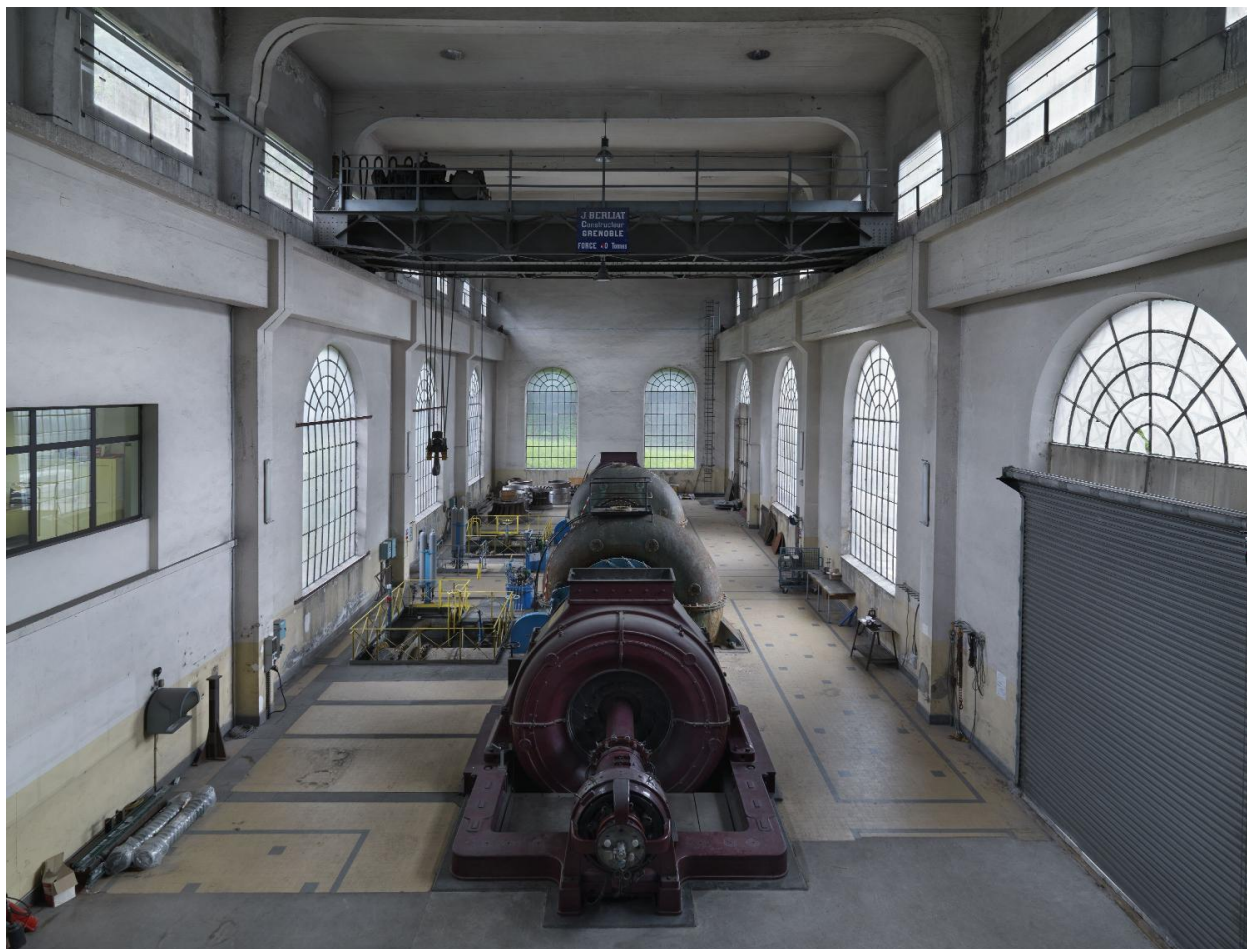
Vue d'ensemble salle des machines
