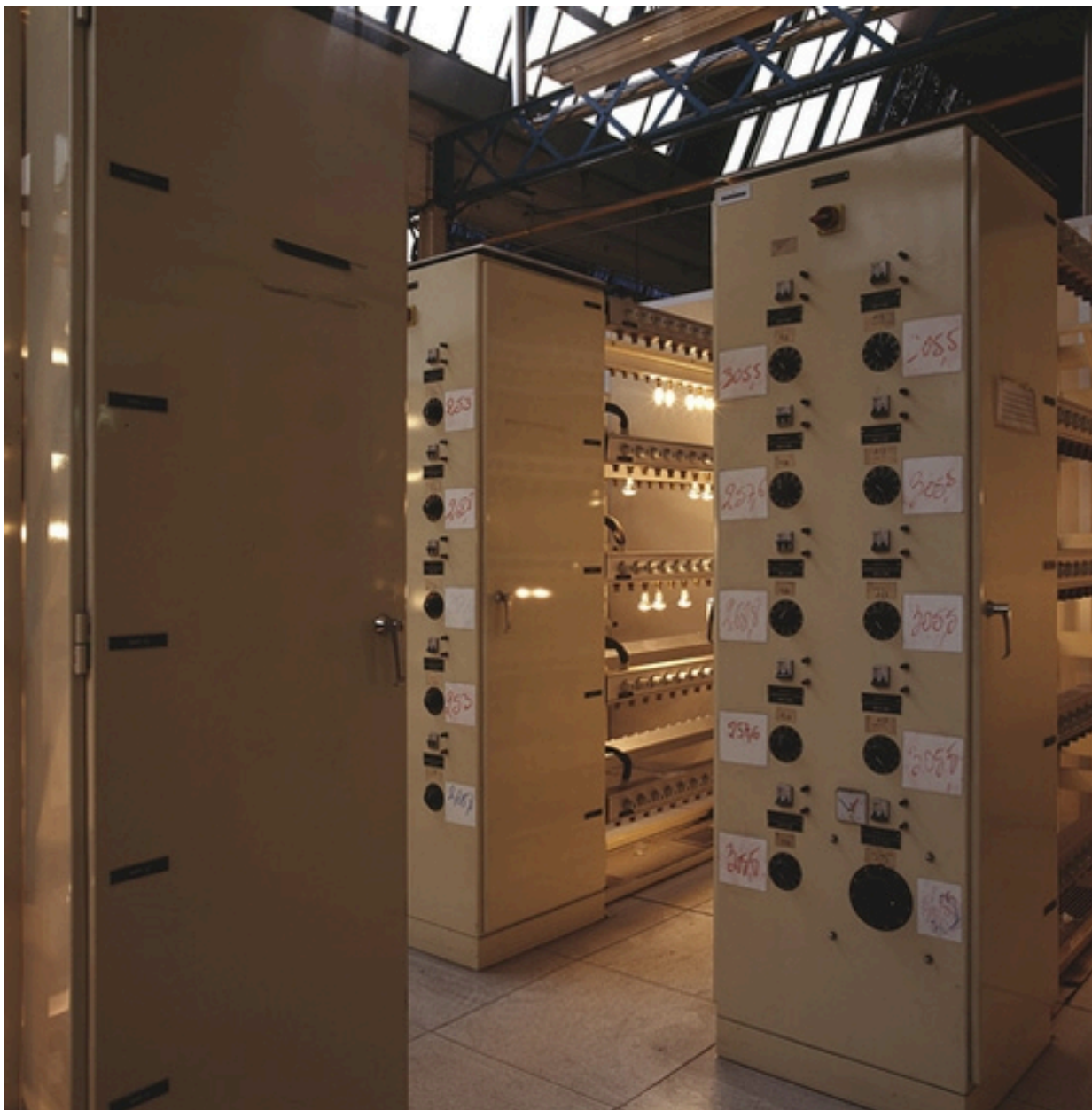
Détail salle de contrôle des durées
