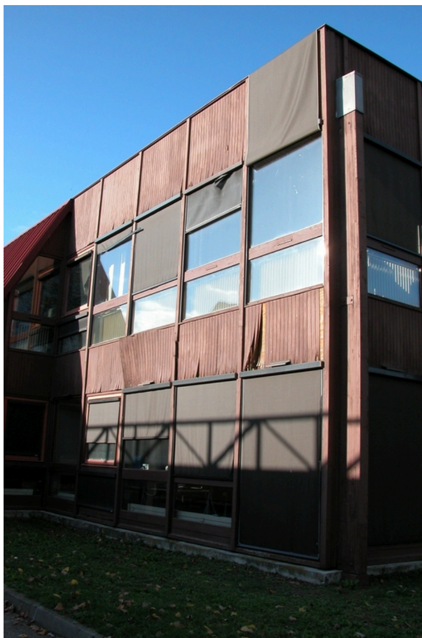
Bâtiment C, façade non restaurée.
