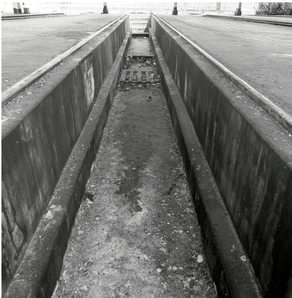
Vue d'une fosse de réparations
