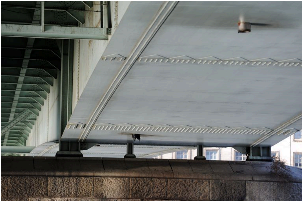
Tablier de la travée gauche, de dessous, vue partielle : jonction de la structure latérale avec la pile (depuis la rive gauche)
