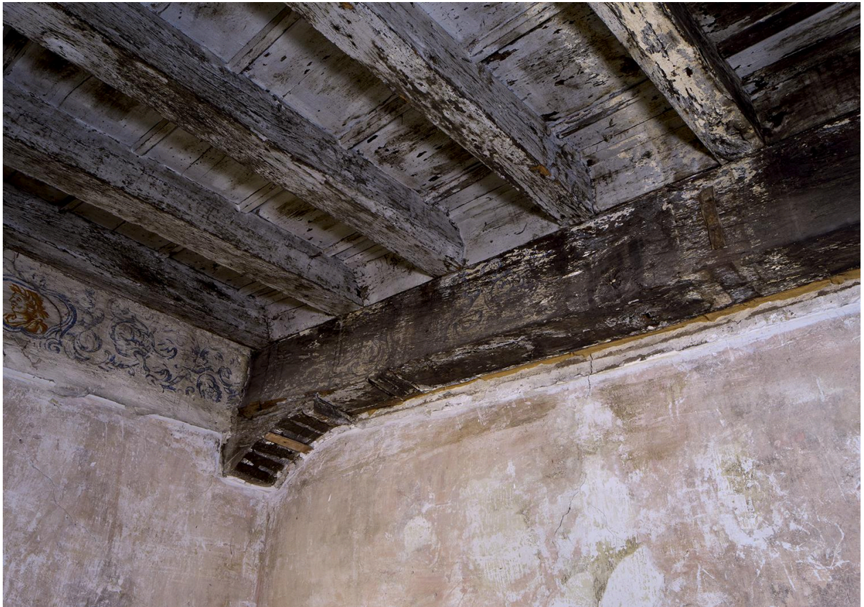
Etage carré de la maison, dégagement entre les chambres 4 et 2, détail du décor porté sur les poutres.
