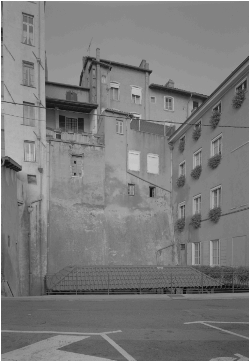
Elévations postérieures sur la rue du Gouvernement des maisons 15 Grande rue (type IV) et 17 Grande rue (type II), avec étages de soubassement sur niveau de soubassement.
