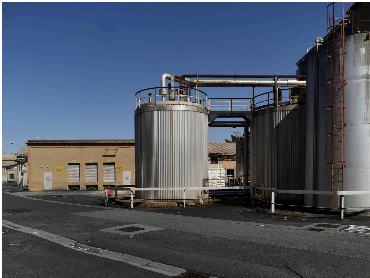
Cuves à l'arrière de la chaufferie, vers la cour de Sardon, et transformateur B52 à l'arrière-plan.
