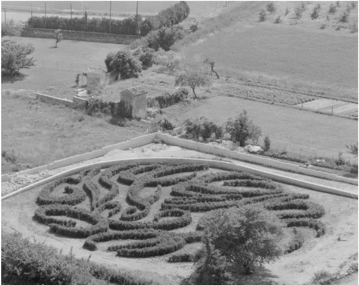
Vue des travaux de mise en place du jardin public : jardin de buis en cours de création. Gros plan depuis la terrasse du château.
