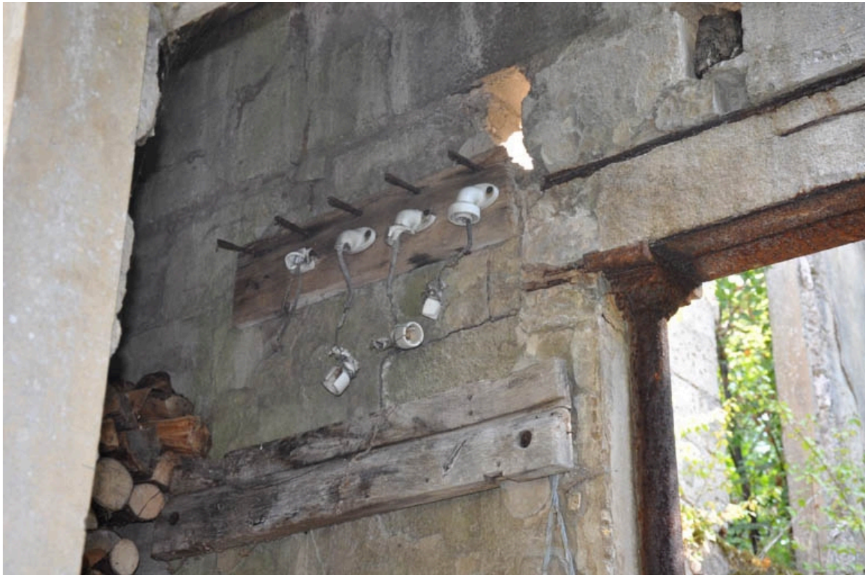
Détail de l'installation électrique de l'usine hydroélectrique
