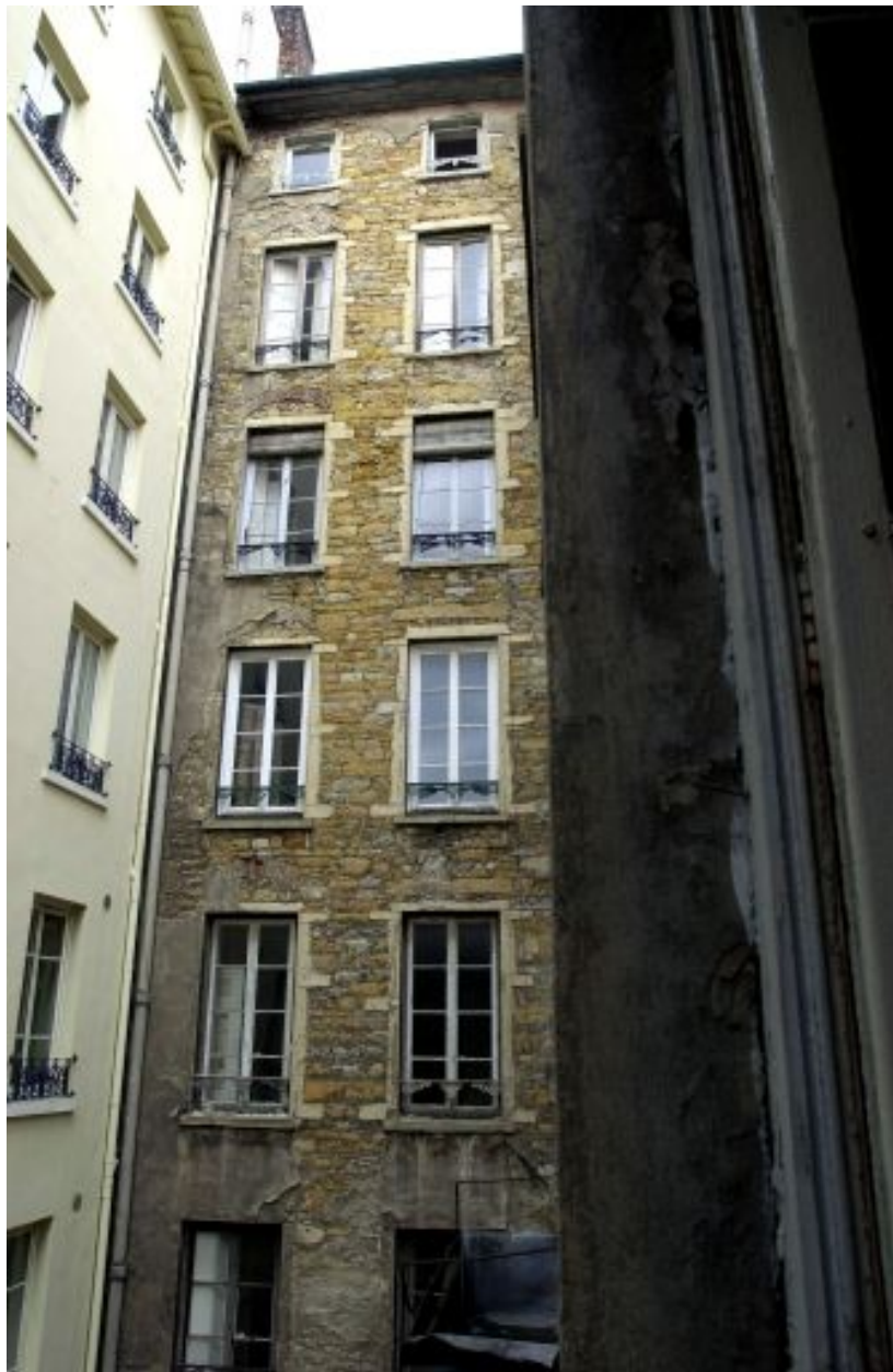
Elévation postérieure de la partie ouest de l'immeuble sur rue, au-dessus de la cour du 3 rue Delandine
