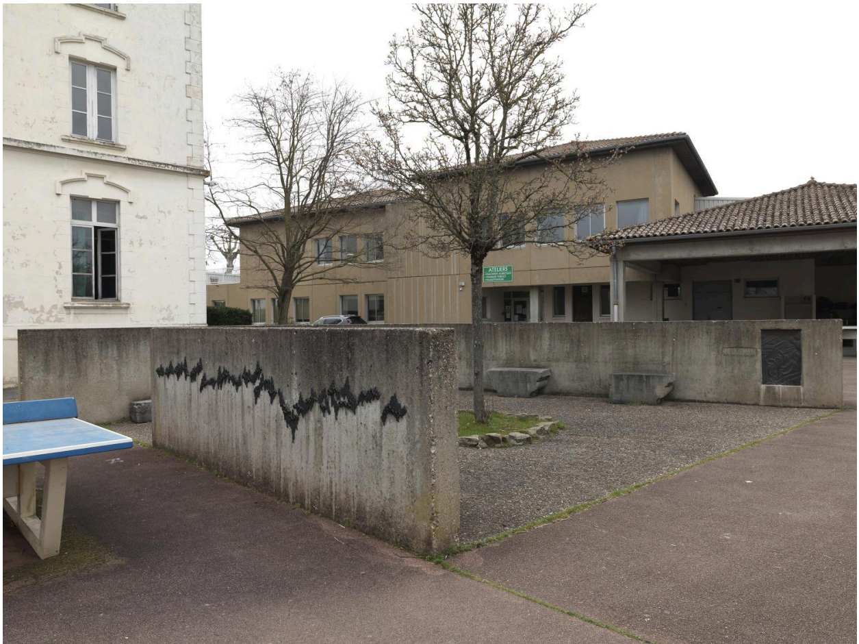
Vue d'ensemble de l'installation.
