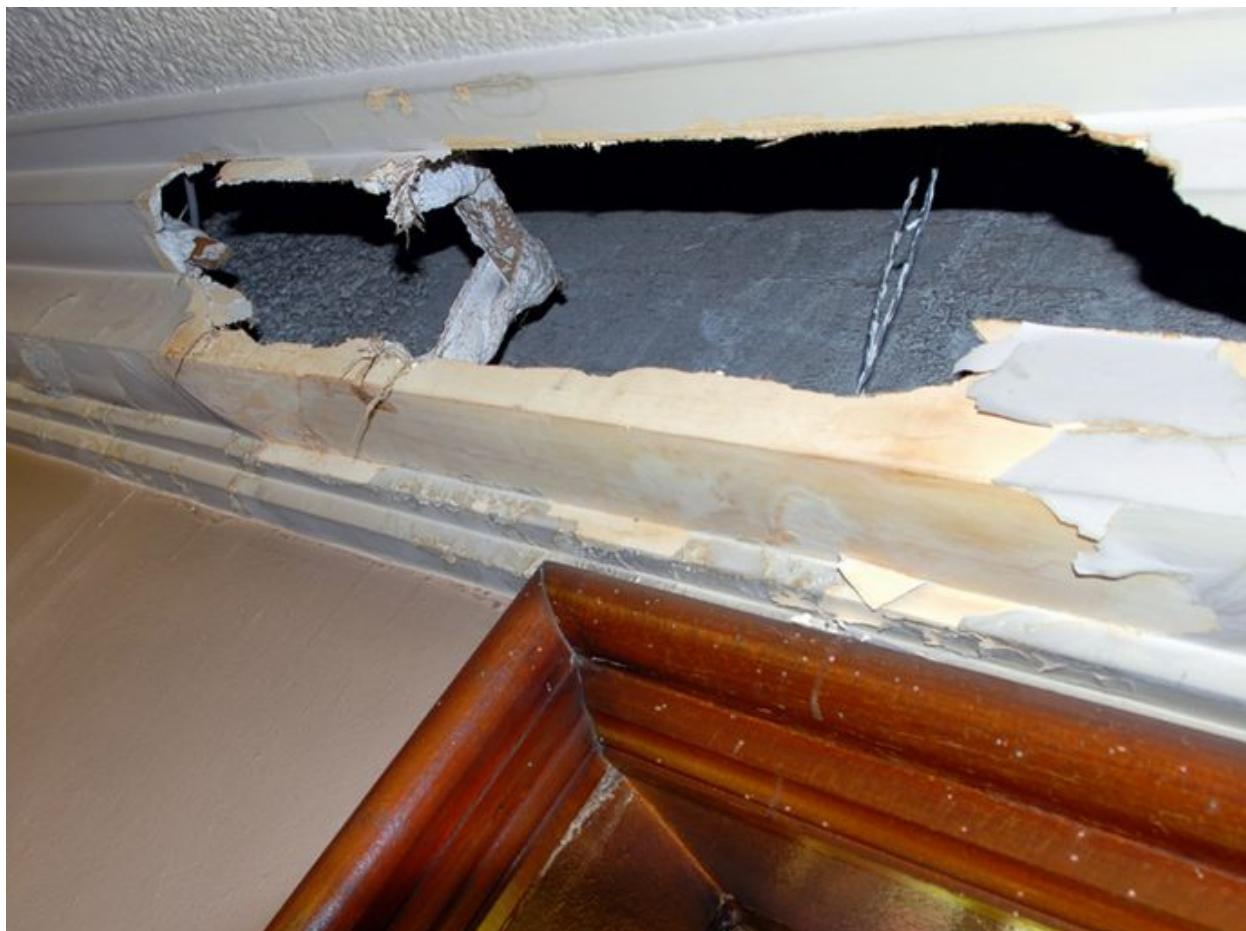
dégradation de la corniche, détail
