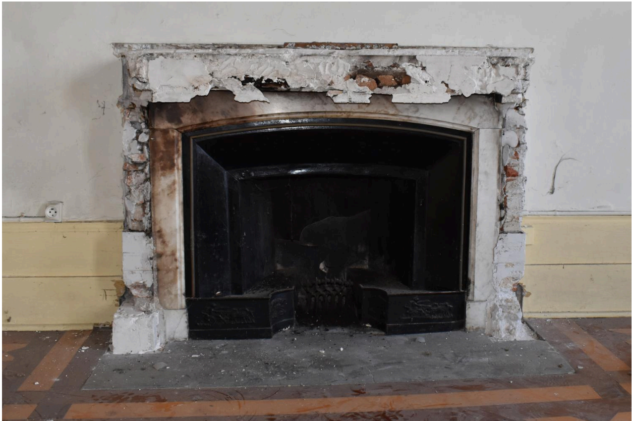
Rez-de-chaussée, chambre de Gabrielle de Tricaud : cheminée dégradée par malveillance
