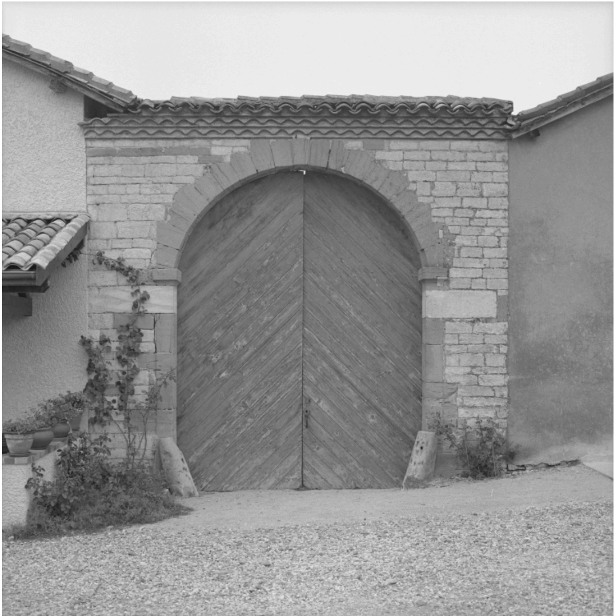
Ferme de type A, située sur la commune de Frans, au lieu dit Les Gajères, parcelle D2 290. Porte charretière fermant la cour.
