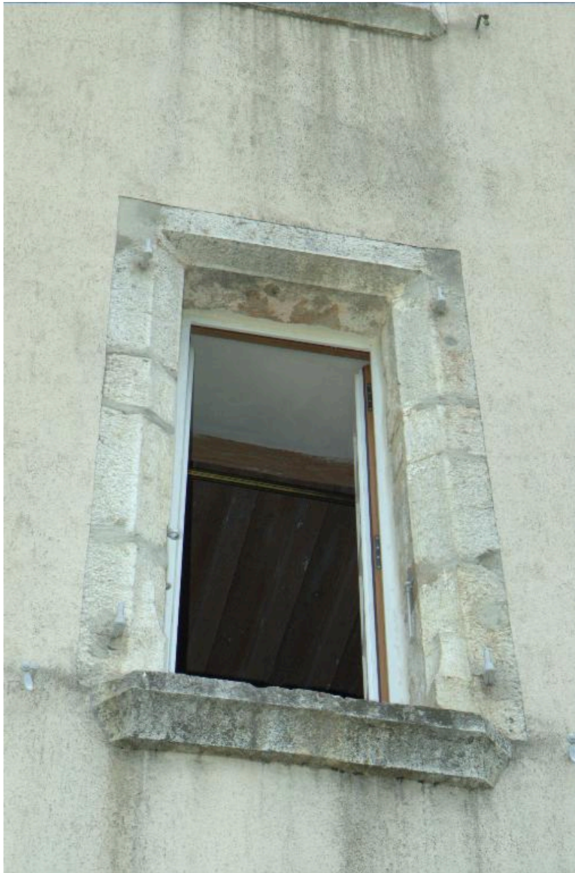
Détail d'une baie de la façade ouest de la tour nord-ouest du château.
